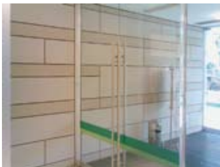
Kaufhof, Frankfurt am Main: Temporärer Graffitienschutz
